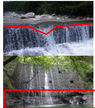
砂防堰堤の基礎洗掘
