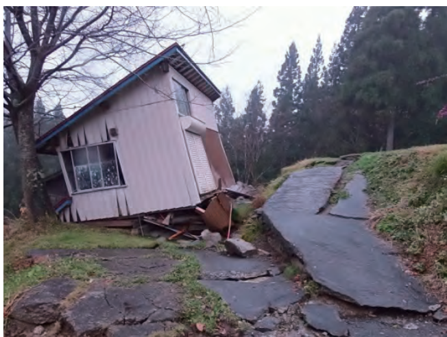
神城断層地震 平成26年11月22日 地すべりにより被災した人家及び村道（小谷村中土）
