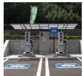
●道の駅に設置されたEV充電設備例
