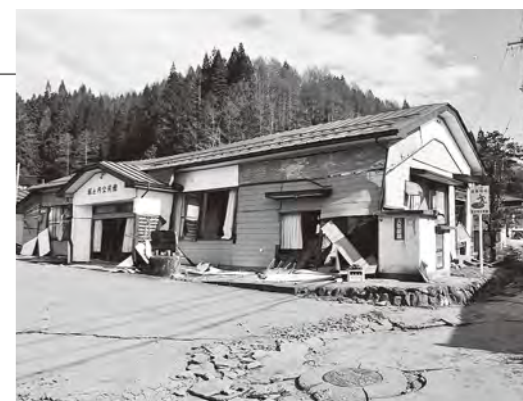
神城断層地震により被災した堀之内公民館
