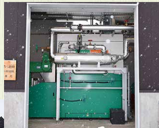
木質チップボイラー▶
