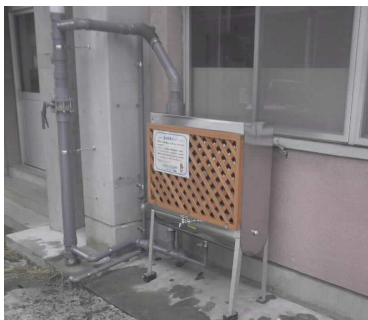
雨水貯留タンク
