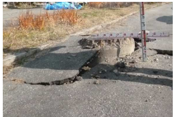
マンホールの隆起 (H26 神城断層地震)
