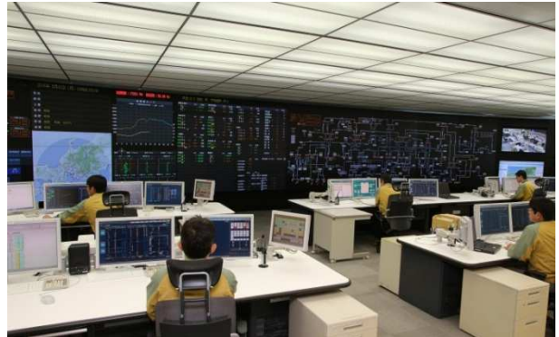
(中央給電指令所 提供：中部電力(株))
