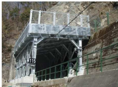
（落石覆い工 提供：JR東海）
