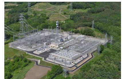
(東信変電所 提供：中部電力(株))
