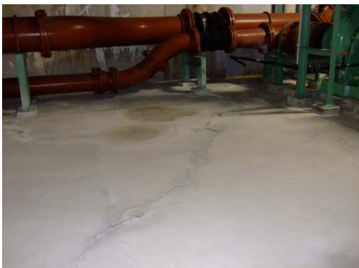
処理場 最終沈澱池管廊のクラック (H23 東日本大震災)
