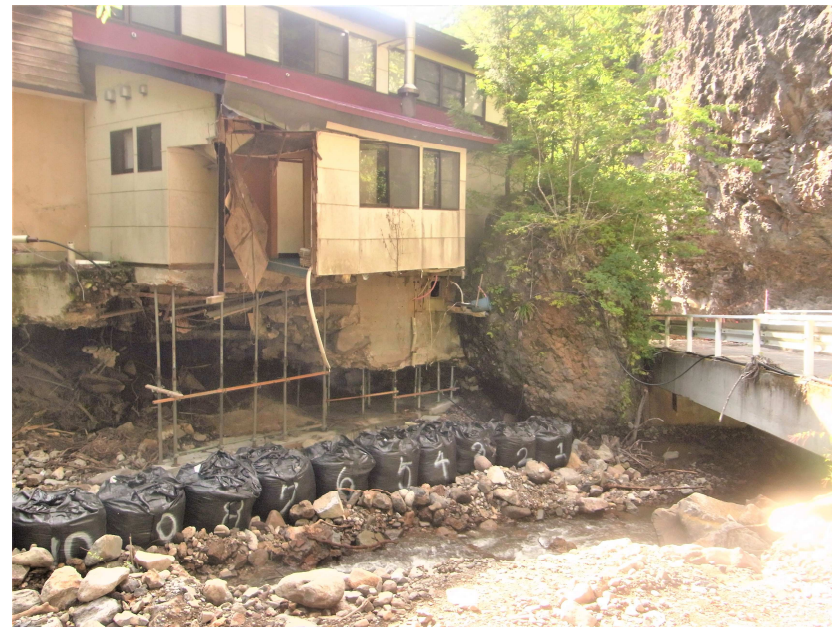
護岸工事の実施後に施設の修繕工事を実施予定（令和2年9月2日撮影）
