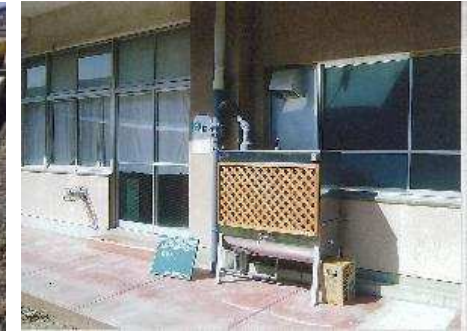
雨水貯留タンク 設置例
