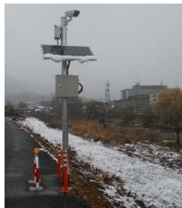
簡易型 河川監視カメラ
