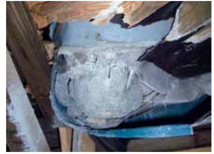
二ノ池本館の屋根を貫通した噴石（小寺）
